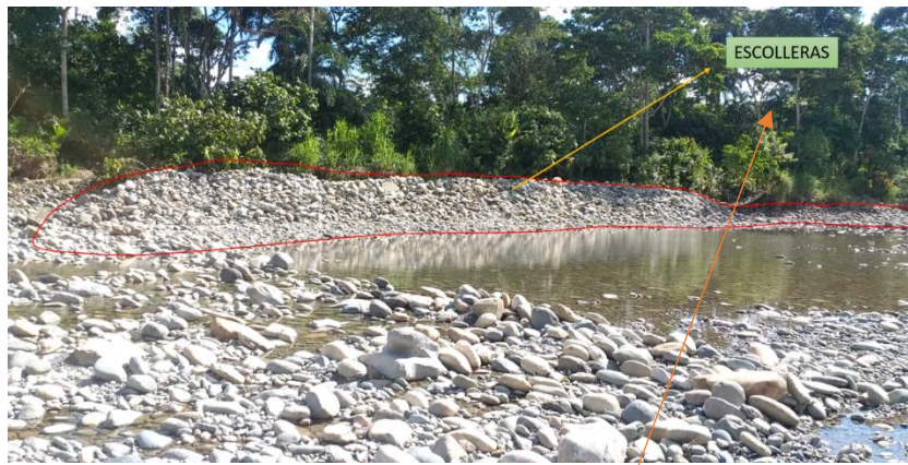
Fotografía: Escollera de protección a las franjas de las rieras del Rio Napo
