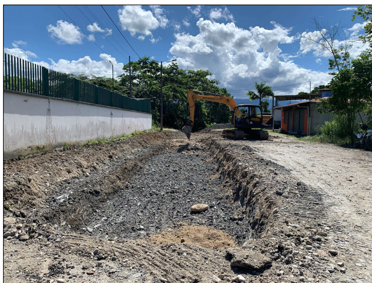
Figura 1. Estado de la vía al momento de la intervención en la Av. Jaime Roldós. Superficie de rodadura lastrada.
