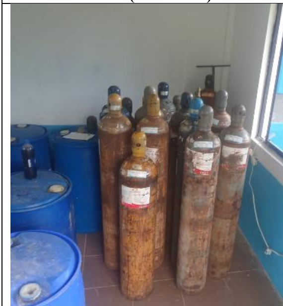
ENTREGA DE INSUMO CLORO GAS EN LA PLANTA DE TRATAMIENTO DE AGUA POTABLE COLONSO (15/12/2025)
