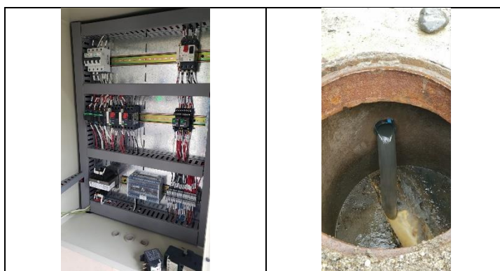
Figura 7. Pruebas de funcionamiento de las bombas
