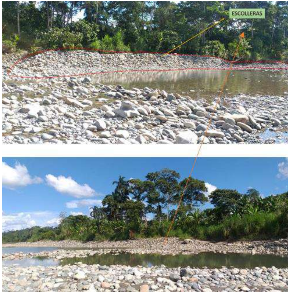
Ilustración 11.- Escollera de protección a las franjas de las rieras del Rio Napo.
